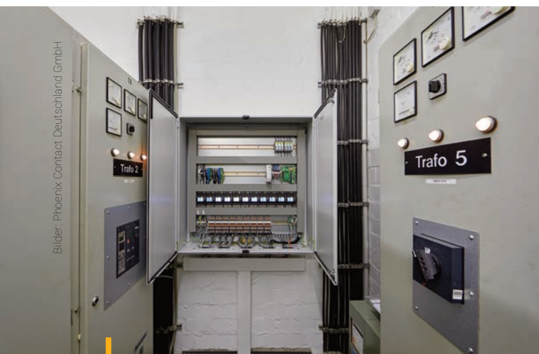
Neue Energiedatenerfassung in einer bestehenden Hauptverteilung
