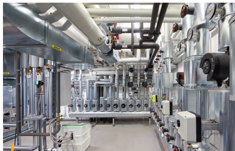
Heiz- und Kühlkreisverteiler eines Bürogebäudes im Technologiezentrum
