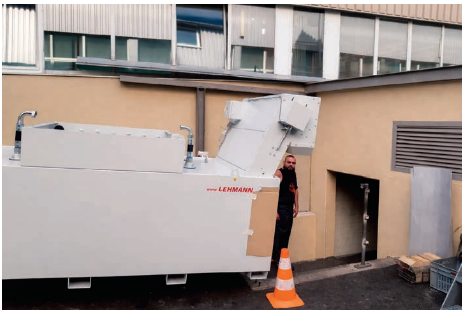
Ausgezeichnet gemessen: Die vormontierte Filteranlage auf dem Weg zum Ziel – und diese passt tatsächlich in die gezeigte Öffnung rechts unten.
