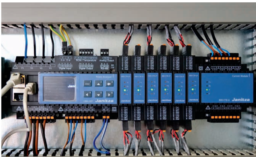
Bild 2 | Der modulare Netzanalysator UMG 801 erfasst in den Niederspannungsverteilungen die Ströme der einzelnen Abgänge über angeschlossene Stromwandler.
