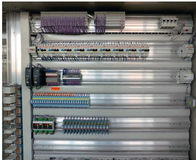
Bild 3 | Platzersparnis und Platzreserven für die Zukunft dank Airstream Schaltschrankverdrahtung.
