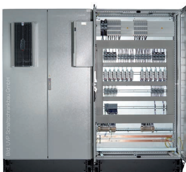
Bild 5 | Papierlos gefertigter Schaltschrank, entspricht zu 100 Prozent dem digitalen Zwilling.
