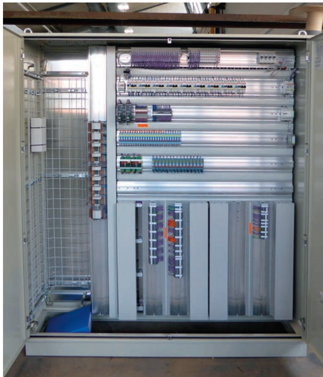
Bild 2 | Steuerungsschaltschränke für die Fernwirkungsanlagen der BLT.
