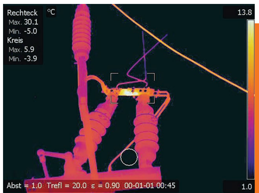
Bild 3 | Bei diesem Oberleitungsschalter sind die Kontakte erwärmt, vermutlich weil nur einer der vier Bolzen die gesamte elektrische Last trägt.
